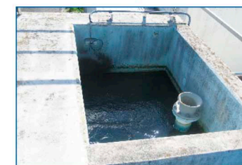
ちやくすい せい 着水井 ダムから導水管を通ってきた水を溜めています。
