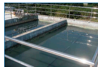
けいせい ち フロック形成池 水の中の小さなゴミを葉の動きで沈みやすいかたまりにします。
